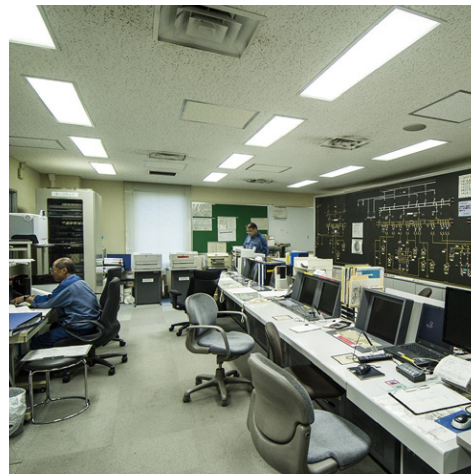
出典:東京電力パワーグリッド
